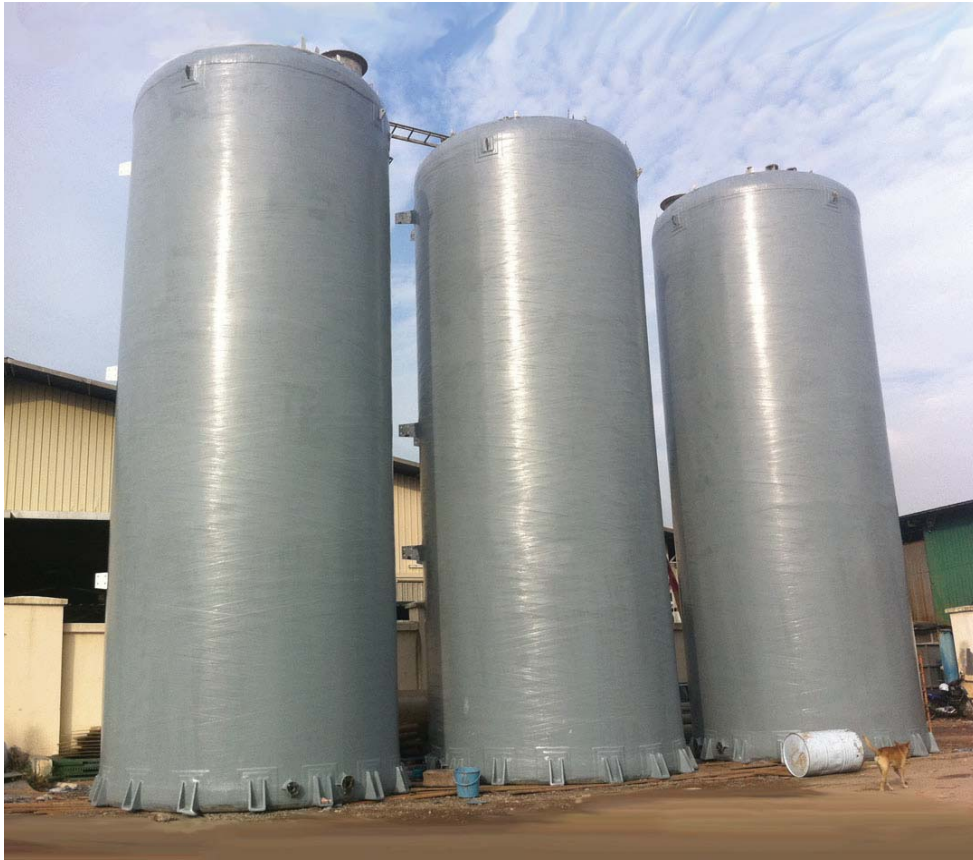
รูปที่ 3-4 ภาพตัวอย่าง ถังเก็บกรดเกลือ ชนิดวางตั้ง (Vertical tank) วัสดุ ไฟเบอร์กลาส
